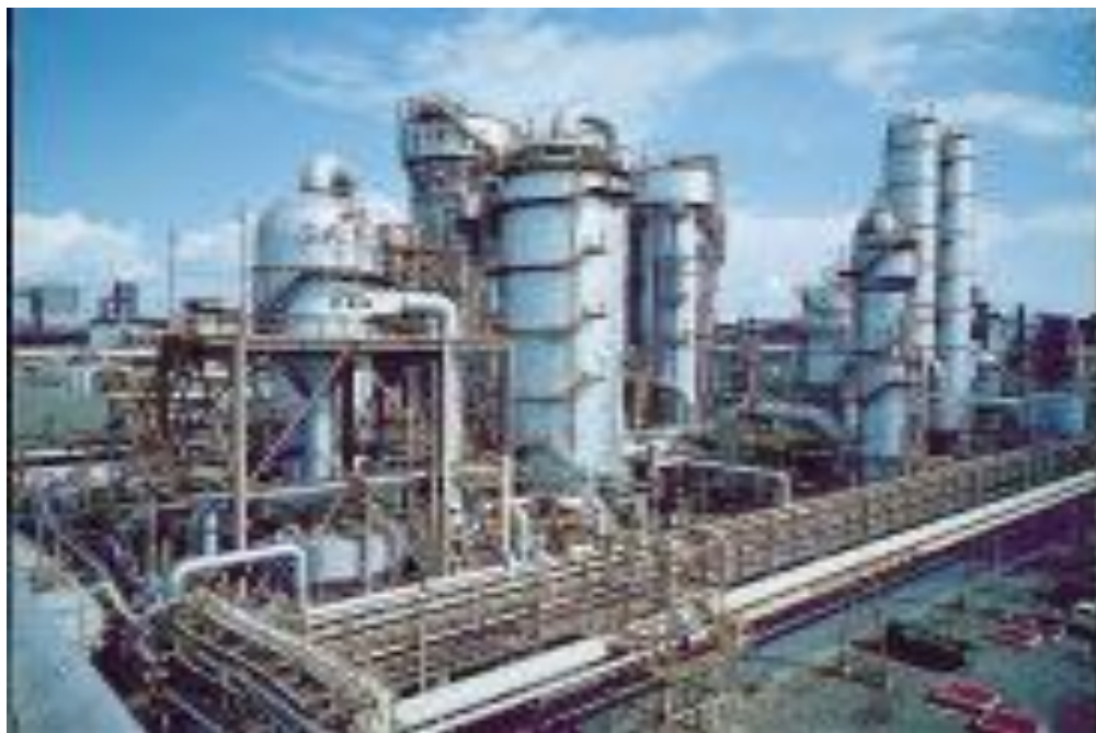
図表 4-3-9 コークス炉ガス脱硫設備
