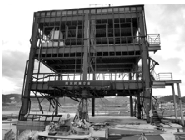
写真2 破壊された防災庁舎
